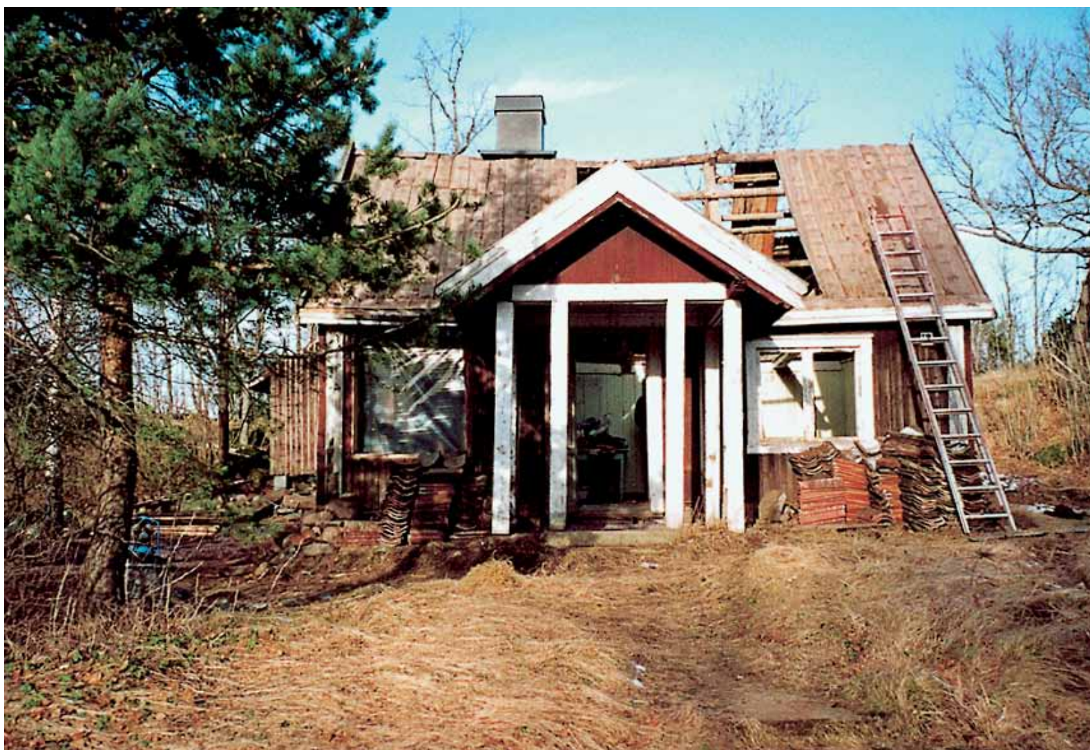
Bentsrudstua i fritt forfall, vinteren 2000.
