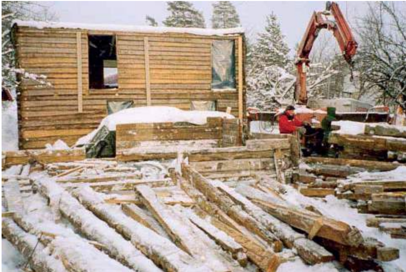
Oppløsing av hovedbygningen i snekaoset vinteren 2001.
