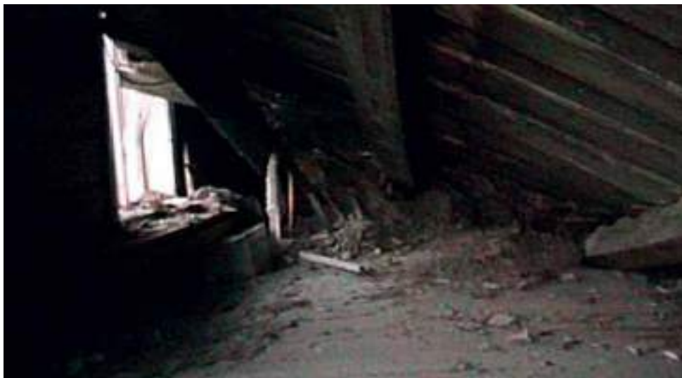
I stuen i 1. etg har himlingen rast ned.
