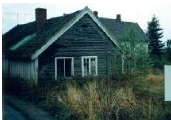
STABBUR OG SVALGANGSHUS VED AAS GÅRDEN I SANDE 2003 – FORFALLET HAR KOMMET LANGT.
