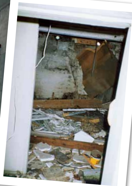
Bad før restaurering.
