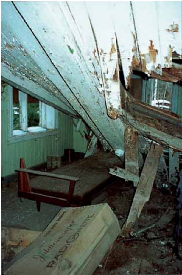
Bentsrudstua i fritt forfall, vinteren 2000.
